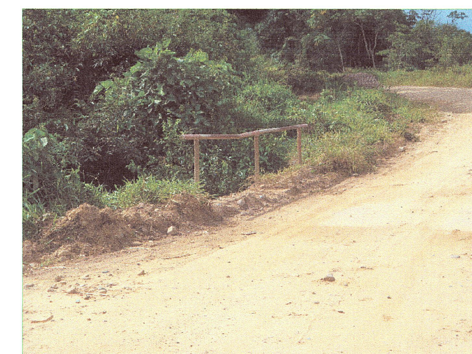
04 Se observa que no tiene losa de aproximación
