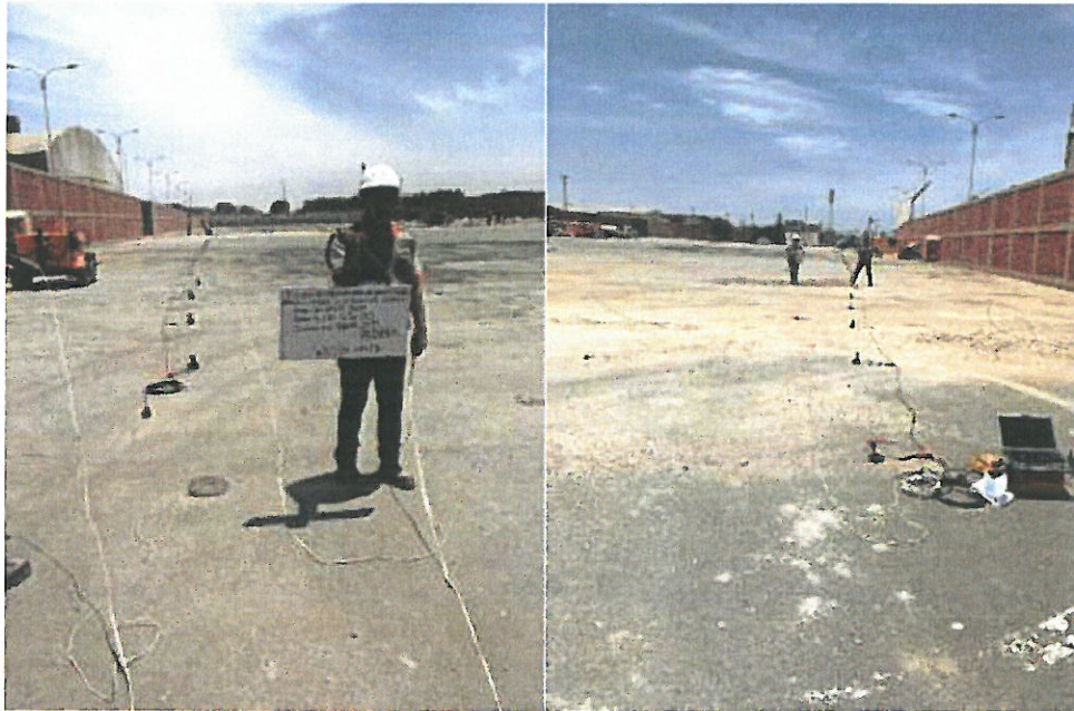
Tendido de la línea sísmica (izquierda) y toma de datos con el equipo Geode Seismic (derecha)
