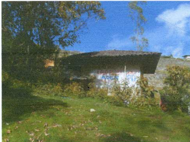
VISTALATERAL IZQUIERDA, DEL PREDIO AFECTADO - NUEVA AFECTACION
