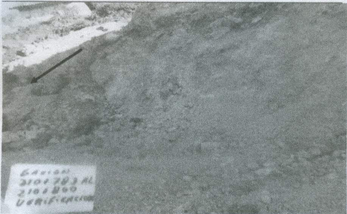
TERRENO DESLIZADO PRODUCTO DE LOS TRABAJOS DE EXPLANACIONES
