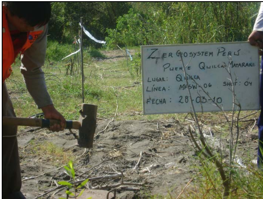
Fotografía 5: Se observa el shot-04 del sondaje 06 ubicado en el margen derecho del río Quilca.
