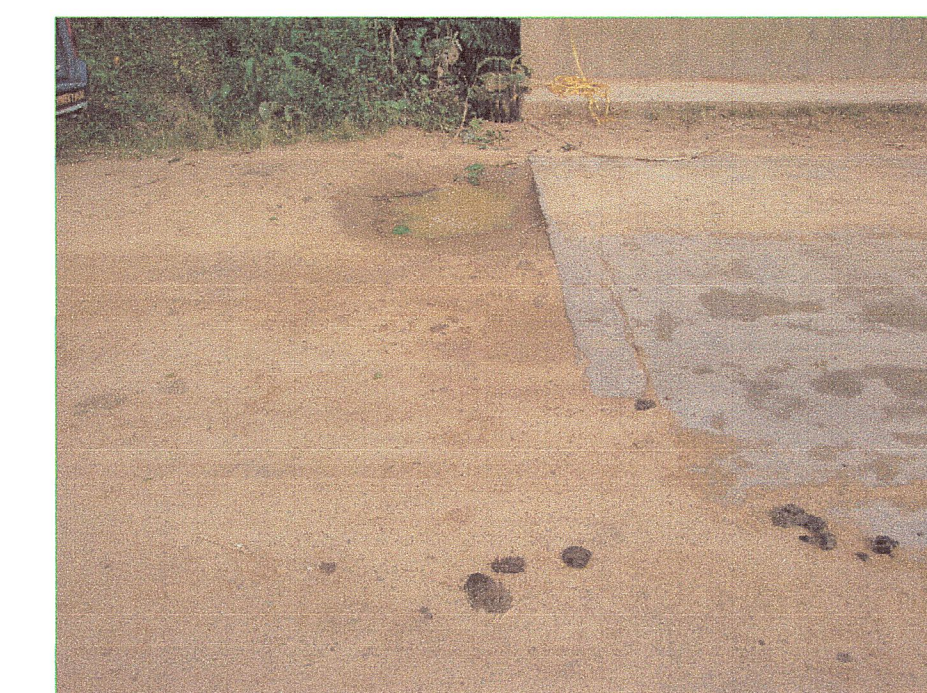
04 Se observa que no tiene losa de aproximacion
