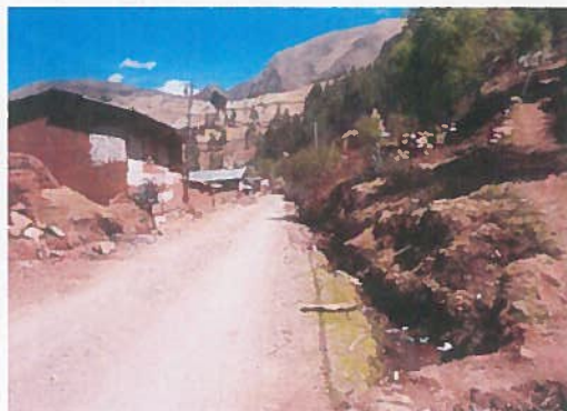
Entrada al distrito de Tambobamba, existe necesidades de ensanche de la vía como trabajos de obras de drenaje laterales.
