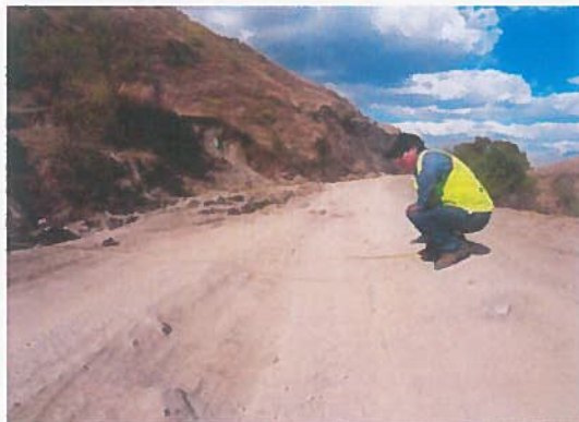
Evaluación respecto al tamo crítico en la vía existente.
