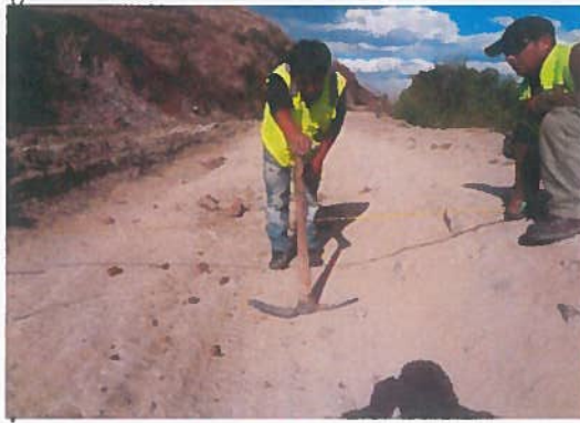
Nótese, las deformaciones respecto al nivel de vía existente. Sector del Km. 56+800 al Km. 56+900.
