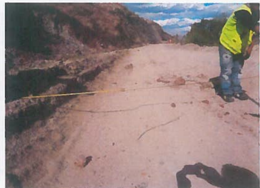
Vista en varios puntos del tramo crítico de la vía existente.
