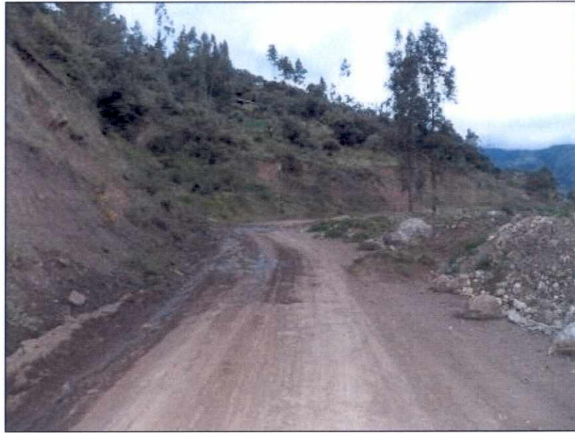
Fig.7: Km 3+420. Carretera con capa de afirmado empobrecido
