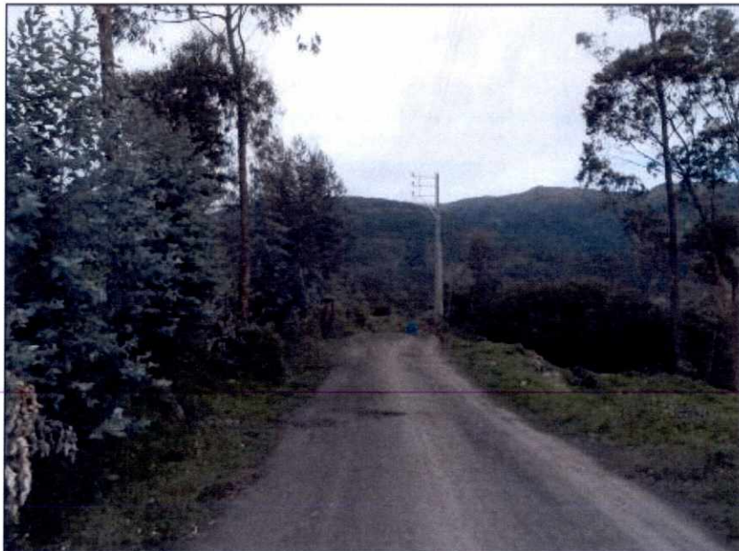
Fig.14: Km 10+500. Carretera con capa de afirmado empobrecido.
