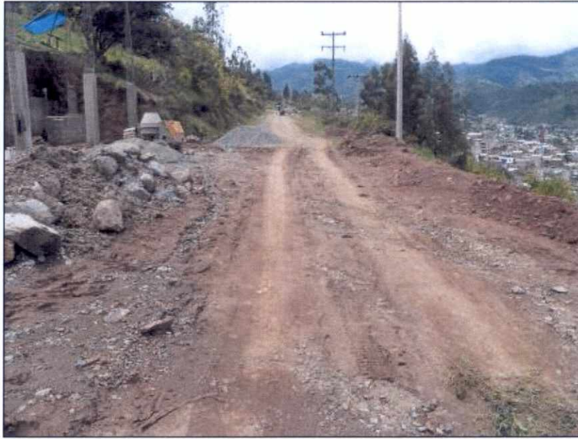
Fig.9: Km 5+400. Carretera con capa de afirmado empobrecido
