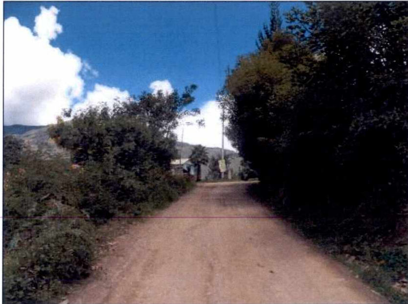
Fig.10: Km 6+500. Carretera con capa de afirmado empobrecido.
