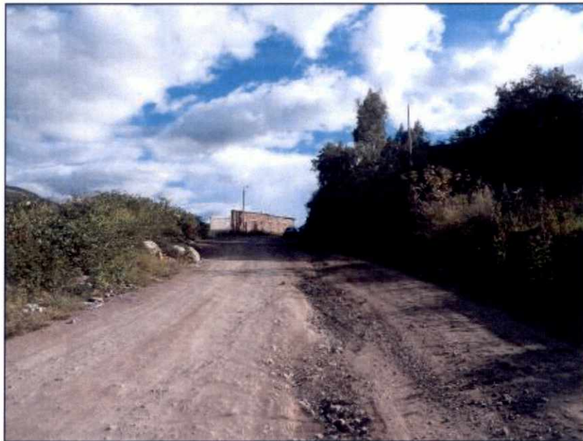
Fig.4: Km 0+580. Carretera con capa de afirmado empobrecido
