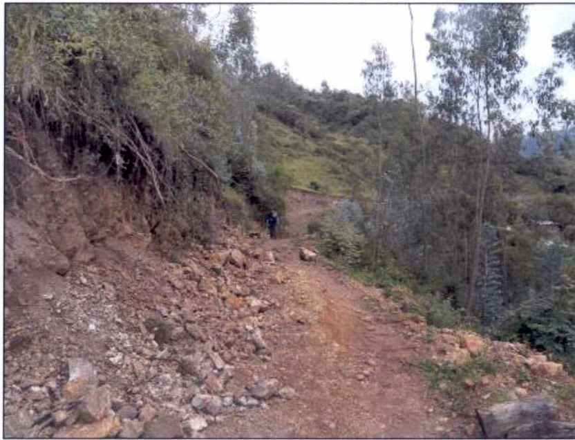
Fig.13: Km 9+600. Zona a media ladera con derrumbes.
