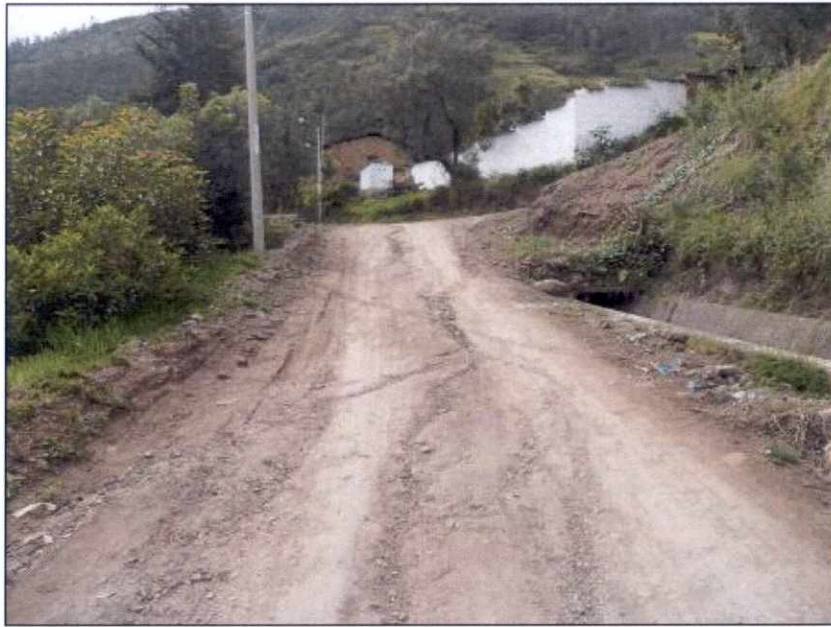
Fig.11: Km 7+400. Carretera con capa de afirmado empobrecido
