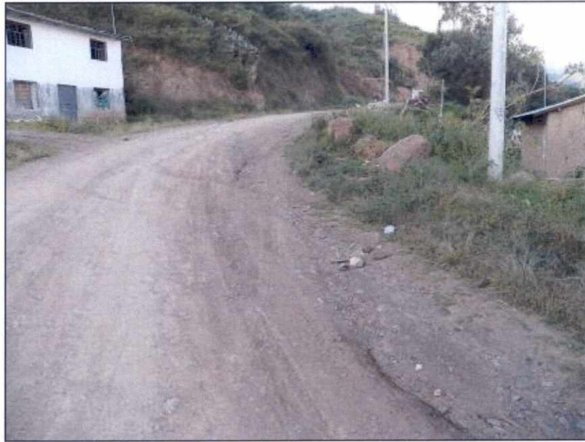
Fig.5: Km 1+400. Carretera con capa de afirmado empobrecido
