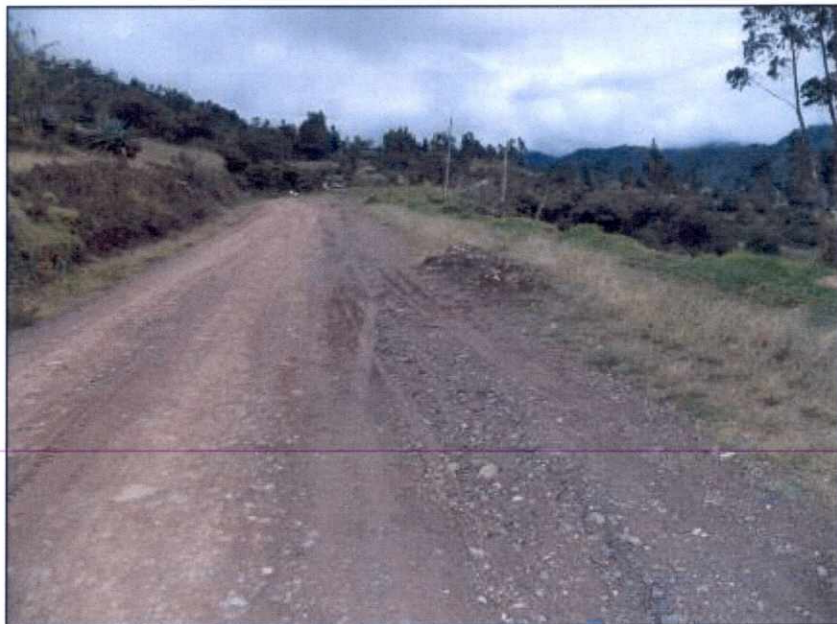
Fig.8: Km 4+480. Carretera con capa de afirmado empobrecido
