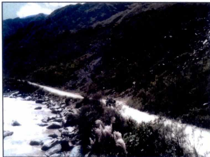
Fotografía 10: Inestabilidad PK 30+500, se aprecia además el riesgo de socavación e inundación por el río
