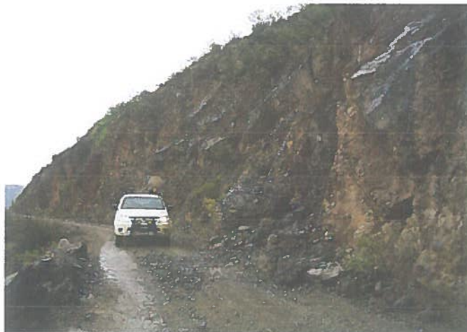
Desprendimiento de Rocas
