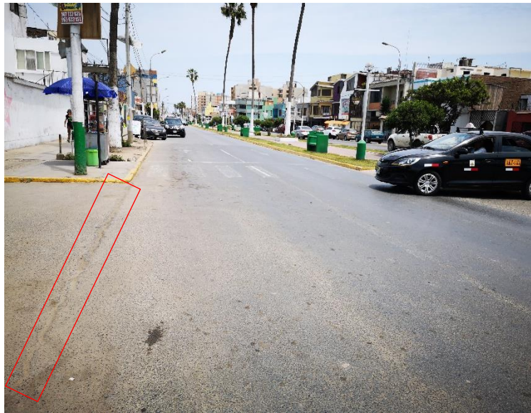
Se puede apreciar fisuras longitudinales de severidad alta y pulimiento de agregados de severidad media.
