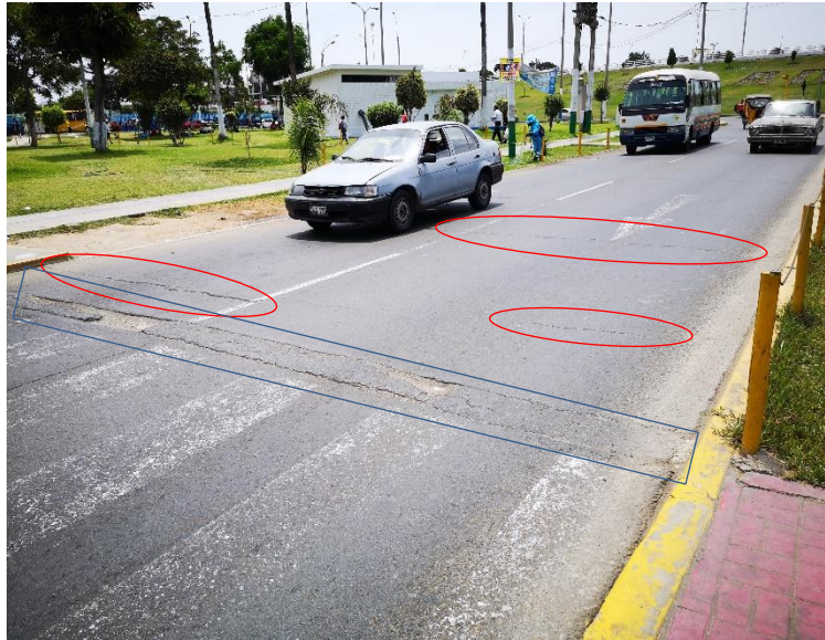
Se puede apreciar parche en pésimo estado de severidad alta, grietas longitudinales de severidad alta y pulimiento de agregados de severidad media.
