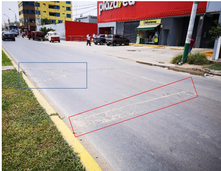
Se puede apreciar la falla parqueo de severidad alta y falla de esquina de severidad alta.
