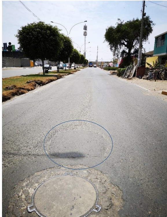
Se puede apreciar pulimiento de agregados de severidad alta y parches de severidad baja
