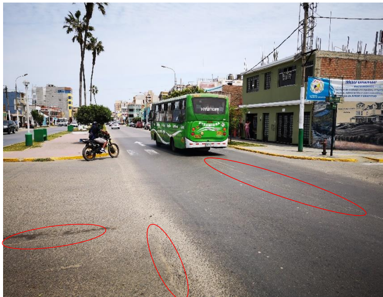
Se puede apreciar fisuras longitudinales de severidad media y pulimiento de agregados de severidad media
