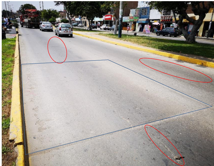
Se puede apreciar losa dividida de severidad baja, grieta lineal de severidad media y pulimiento de agregados de severidad media.
