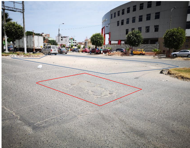
Se puede apreciar huecos de severidad alta, pulimiento de agregados de severidad alta y piel de cocodrilo de severidad alta
