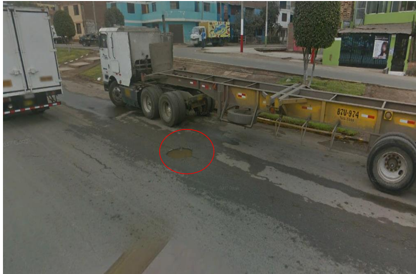
Se puede apreciar huecos de severidad media en la vía.
