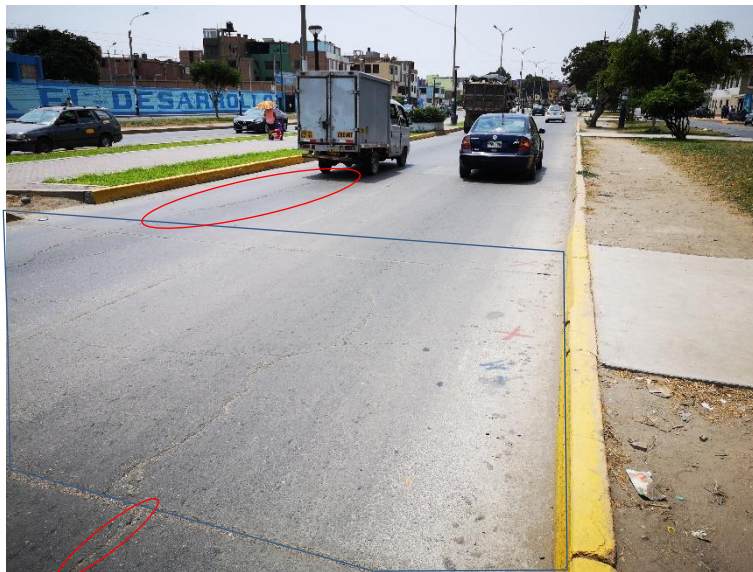
Se puede apreciar losa dividida de severidad media y grietas longitudinales de severidad alta.
