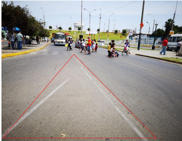
Se puede apreciar desprendimiento de agregados de severidad baja.
