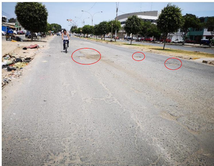
Se puede apreciar huecos de severidad alta, pulimiento de agregados de severidad alta y piel de cocodrilo de severidad alta.
