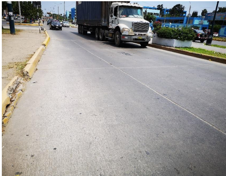
Se puede apreciar pulimiento de agregados de severidad baja.
