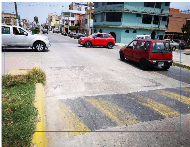
Se puede apreciar la falla pulimiento de agregados de severidad alta.
