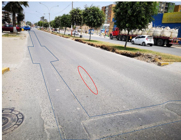
Se puede apreciar fisura longitudinal de severidad baja, pulimiento de agregados de severidad media y parcheo de severidad media
