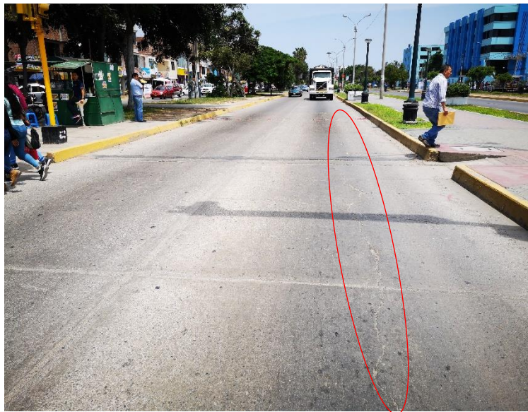
Se puede apreciar grieta lineal de severidad alta y pulimiento de agregados de severidad media.
