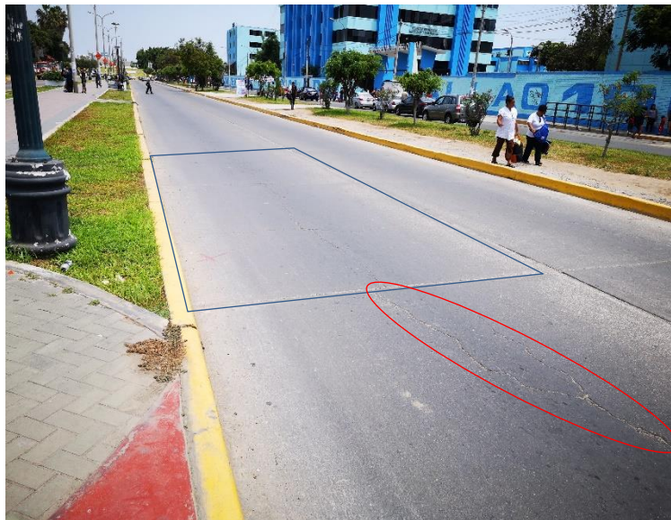
Se puede apreciar fisura longitudinal de severidad alta, losa dividida de severidad baja y pulimiento de agregados de severidad baja.
